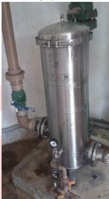
Fonte: Setor de tratamento de água – SETRAT II.
