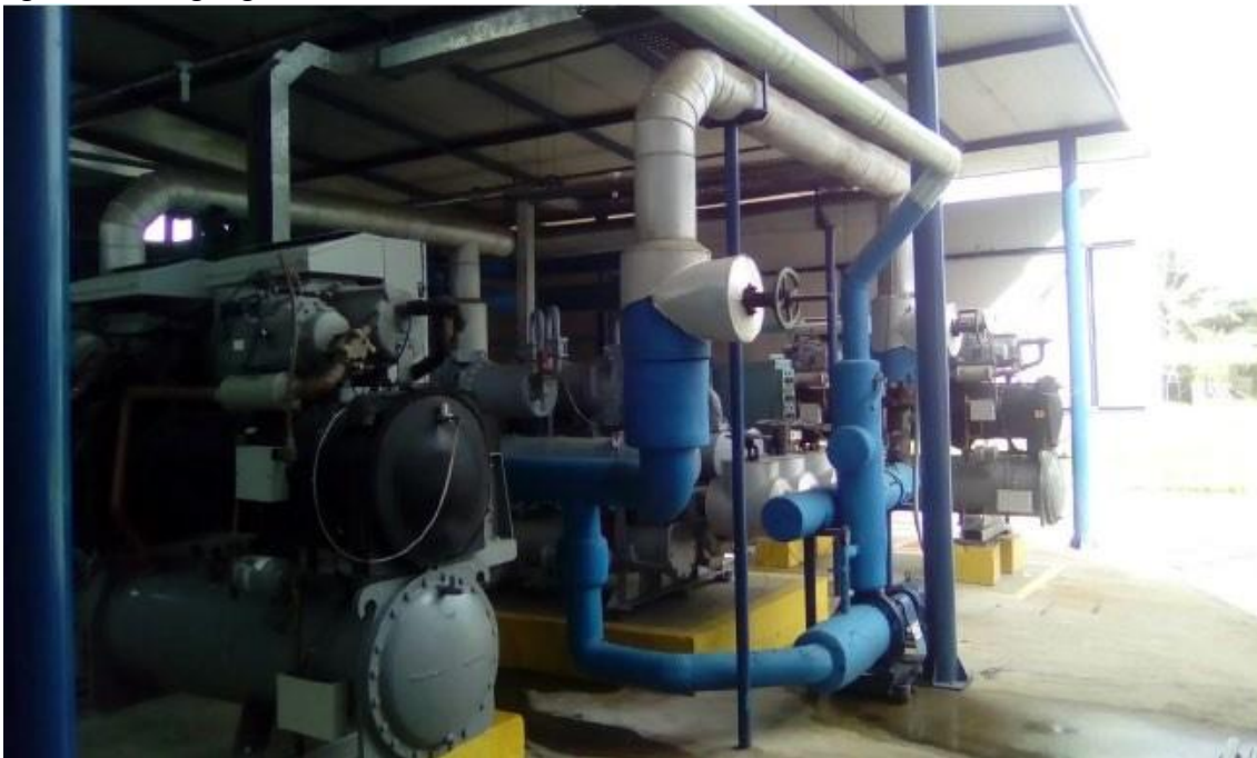
Figura: Chiller água gelada
