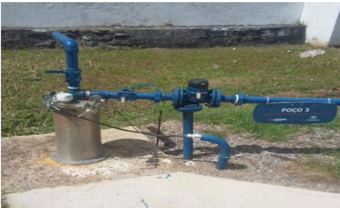
Figura: Poço de abastecimento
